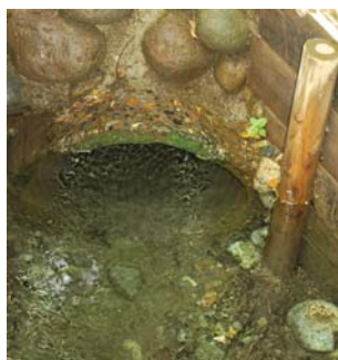
集水管の出口
