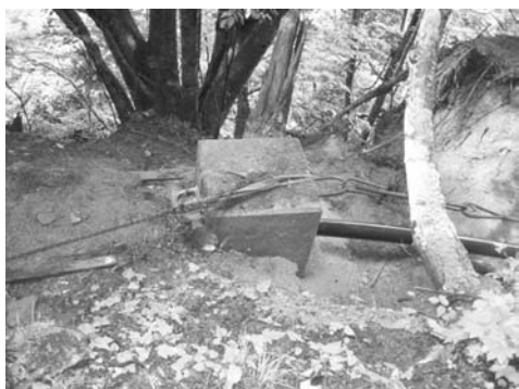
新湯簡易水道の導水施設
