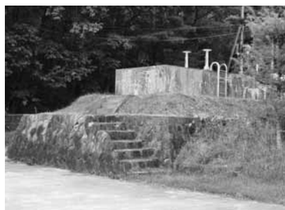
要害浄水場 着水井
