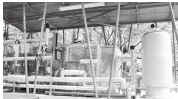
健康のゆぐリーングリーンに設置しているヒートポンプ
