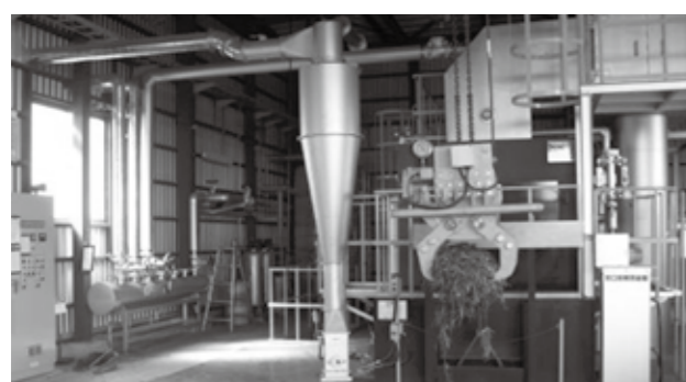
バイオマスボイラー(写真提供:二宮木材株式会社)
