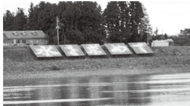
戸田調整池の斜面を利用した太陽光発電システム
